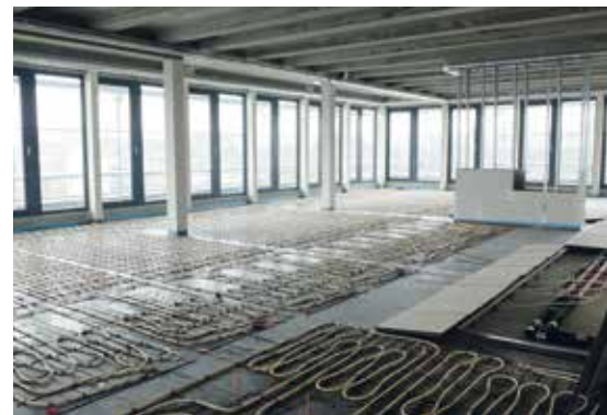
Fußbodenheizung in den Etagen
